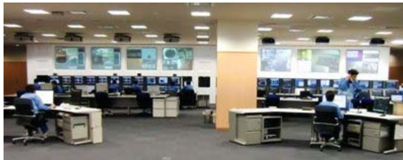
水島工場統合コントロール室内
